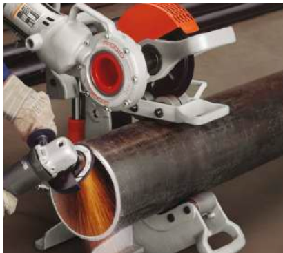
Модель 258 с роликовой опорой трубы в процессе использования для снятия фаски. Для этой операции рекомендуется привлекать двух операторов
