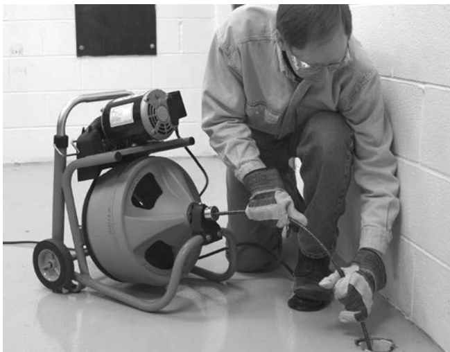
Figura 12 – Înpoziție de exploatare, cablu alimentat manual
